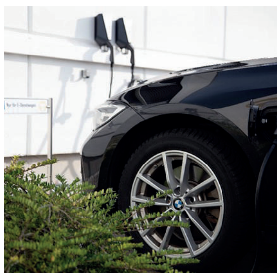
Ladeinfrastruktur bei der Thomas GmbH Deutschland
